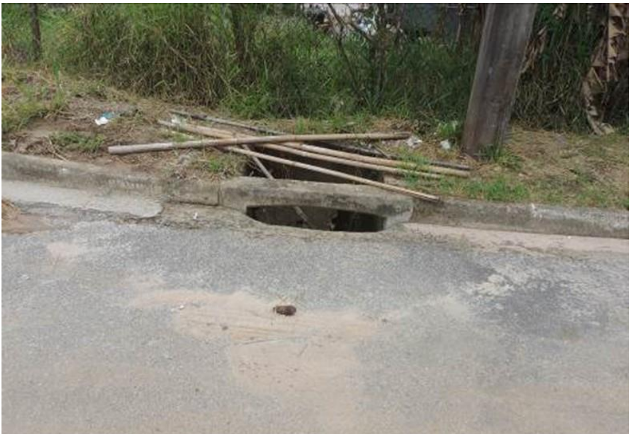
FOTOS: Boca de lobo na Rua Caripuna, Chácaras Reunidas Ygarapés.
