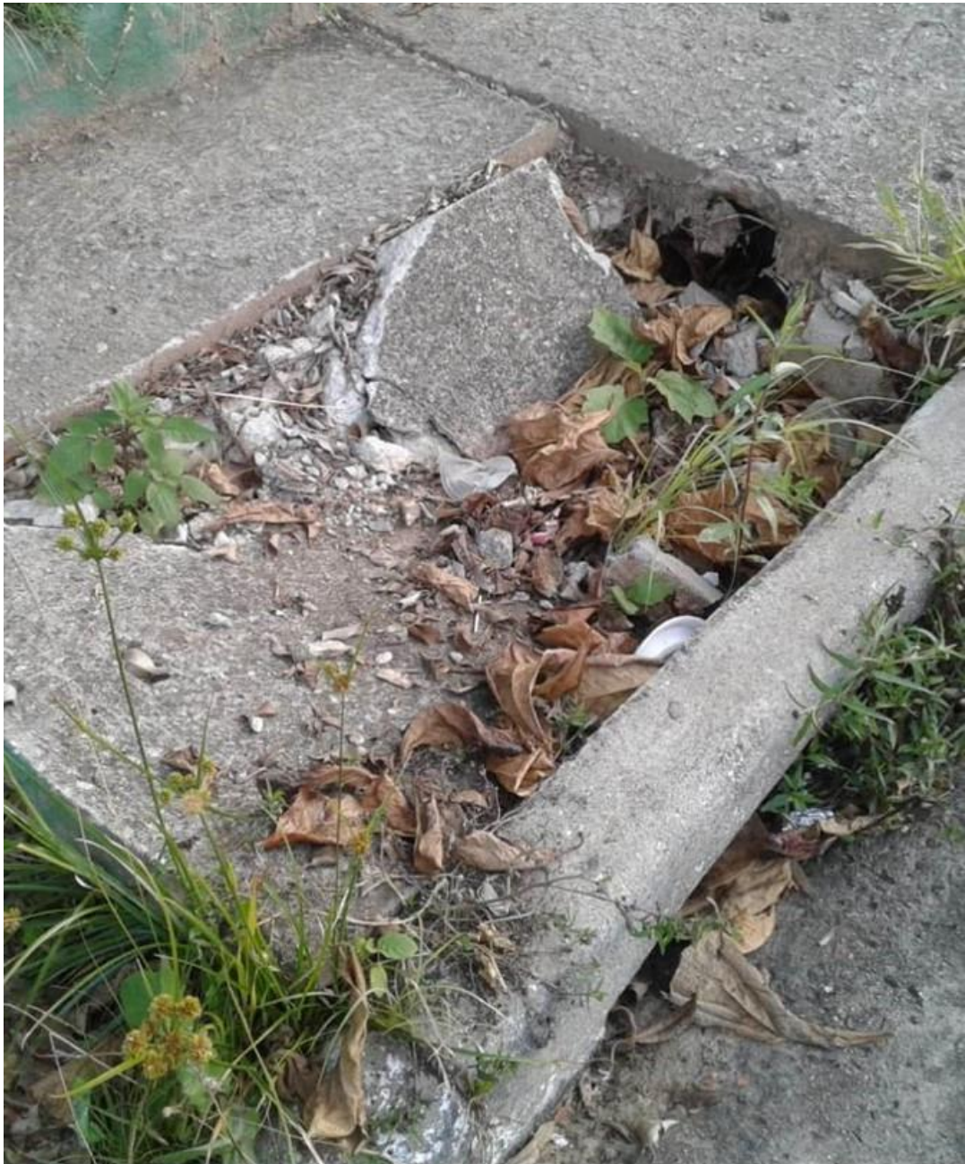
FOTO: Tapa de bueiro quebrada na Praça Maria Alves Ventura, no Bairro Cidade Nova Jacareí.
